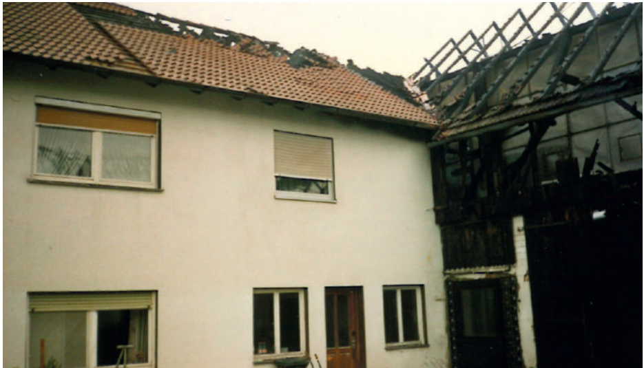
Die von den Flammen zerstörte Scheune und das angrenzende Wohnhaus von Johann Sedlmeier am Tag nach dem Großbrand.
